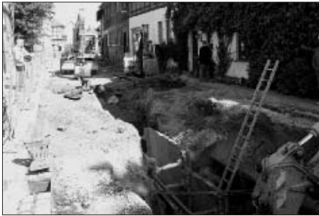
Die Straßenbaumaßnahme in der Ringstraße wurde Mitte April 2007 mit der Verlegung der Schmutz- und Regenwasserkanäle begonnen. Die Kanalver-
