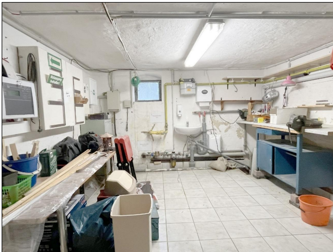
Keller nebst Heizungsanlage
