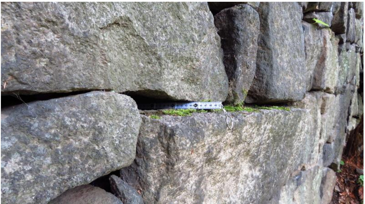
Abbildung 6: Tiefe Spalten in der Bruchsteinwand – Stand 30.06.2017.
