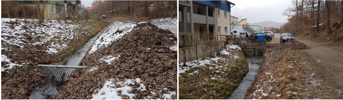
Abbildung 2: Nesselbach mit Rechen, der regelmäßig mit Laub zugesetzt ist (links) und rechts der Abschlag zum Freizeitpark (Quelle: Steinbacher-Consult, Januar 2018).
