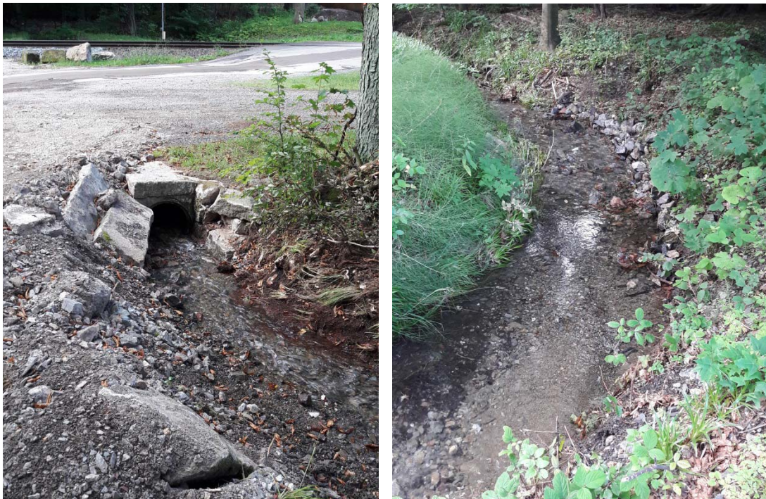
Abbildung 8: Goslarsche Gleie wird im Bereich der Bahnschienen als Verrohrung in die Holtemme geführt (links) und zeigt rechts sehr hohen Sedimenttransport (Quelle: UHV, August 2017).
