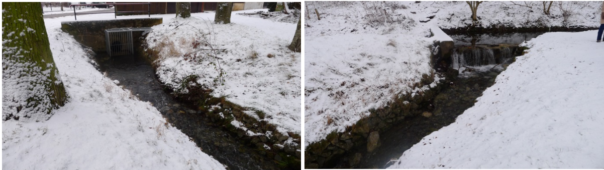
Abbildung 5: Beginn der Verrohrung nach Vereinigung von Mastkopftal und Sturzbach (Quelle: Steinbacher-Consult, Januar und Februar 2018)
