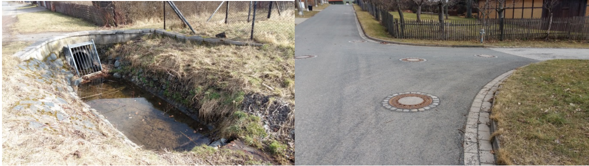
Abbildung 27: Beginn Verrohrung Kaxgrundbach in Benzingerode und Kreuzungsbereich mit Schächten verschiedener Kanäle (Quelle: Steinbacher-Consult, März 2018).
